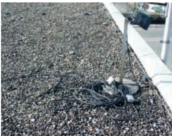
Chybná instalace, nedodržena oddělovací vzdálenost „s“: Připojení s použitím oddělovacího jiskřiště nelze doporučit. Osvětlení by mělo být přemístěno do ochranného prostoru jímací tyče.
